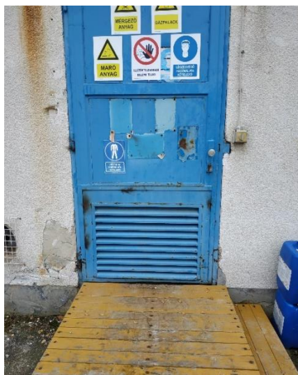
2.kép: Klórtároló helyiség bejárata – botlás- és elesésveszélyes Forrás: szerző saját készítése
