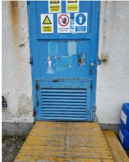
2.kép: Klórtároló helyiség bejárata – botlás- és elesésveszélyes Forrás: szerző saját készítése
